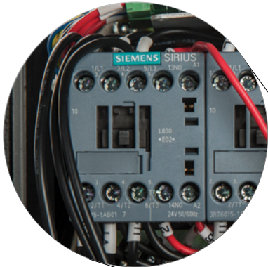
SIEMENS besturingssysteem / SIEMENS relais
